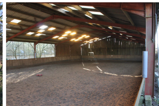
30. Vue du manège. Structure acier, plaques amiantées probables
